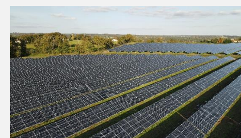
Centrale Solaire d'EXIDEUIL Département : Charente (16) Puissance électrique : 9600 kWc Mise en service : Décembre 2020
